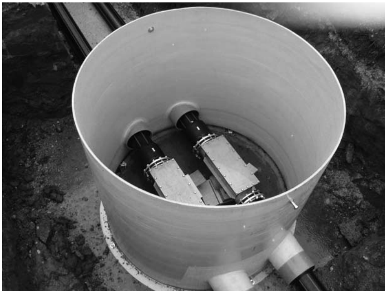
Slika 3.: Čistilni kosi na cevovodih za izcedno vodo.
