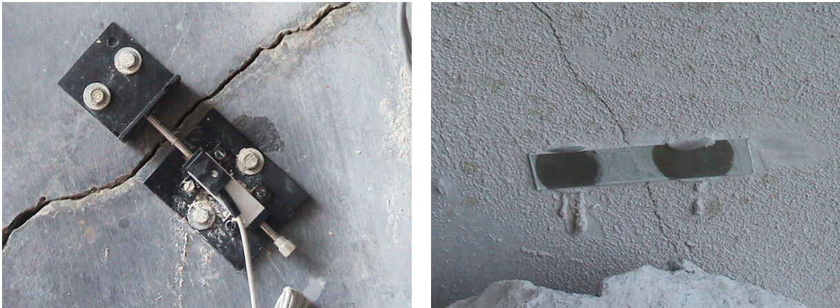
Slika 9., 10.: Meritve in spremljava pomikov odprtih razpok.
